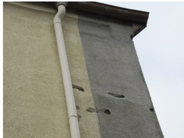
Außenfassade mit Spechtlöchern
