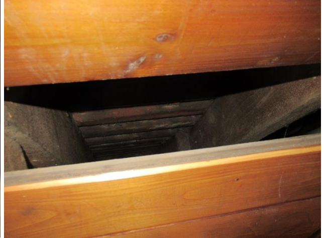
fehlendes Stück in Holzverkleidung
