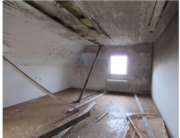
Dachgeschoss (Nordseite) mit durchhängender Decke
