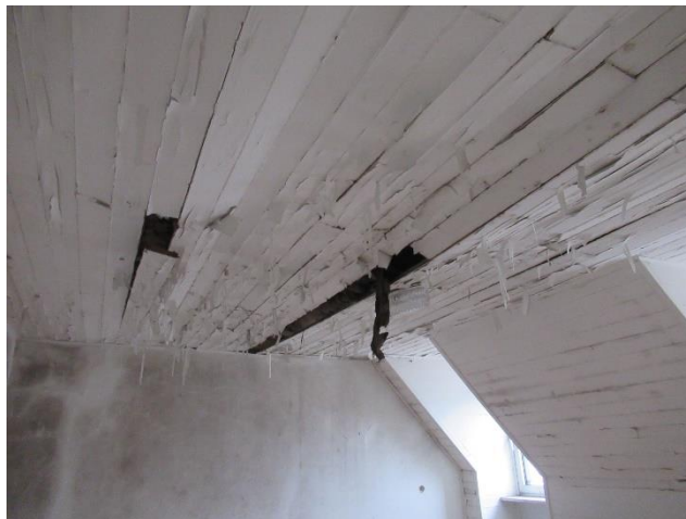
Durchhängende Decke im Dachboden
